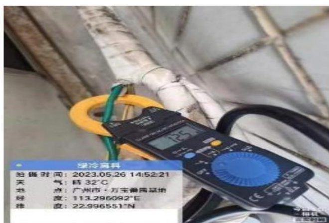
空调运行电流12.5安培
