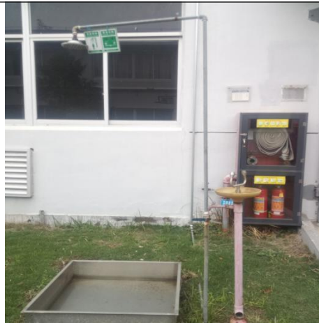
化学品仓洗眼器及周边消防设施
