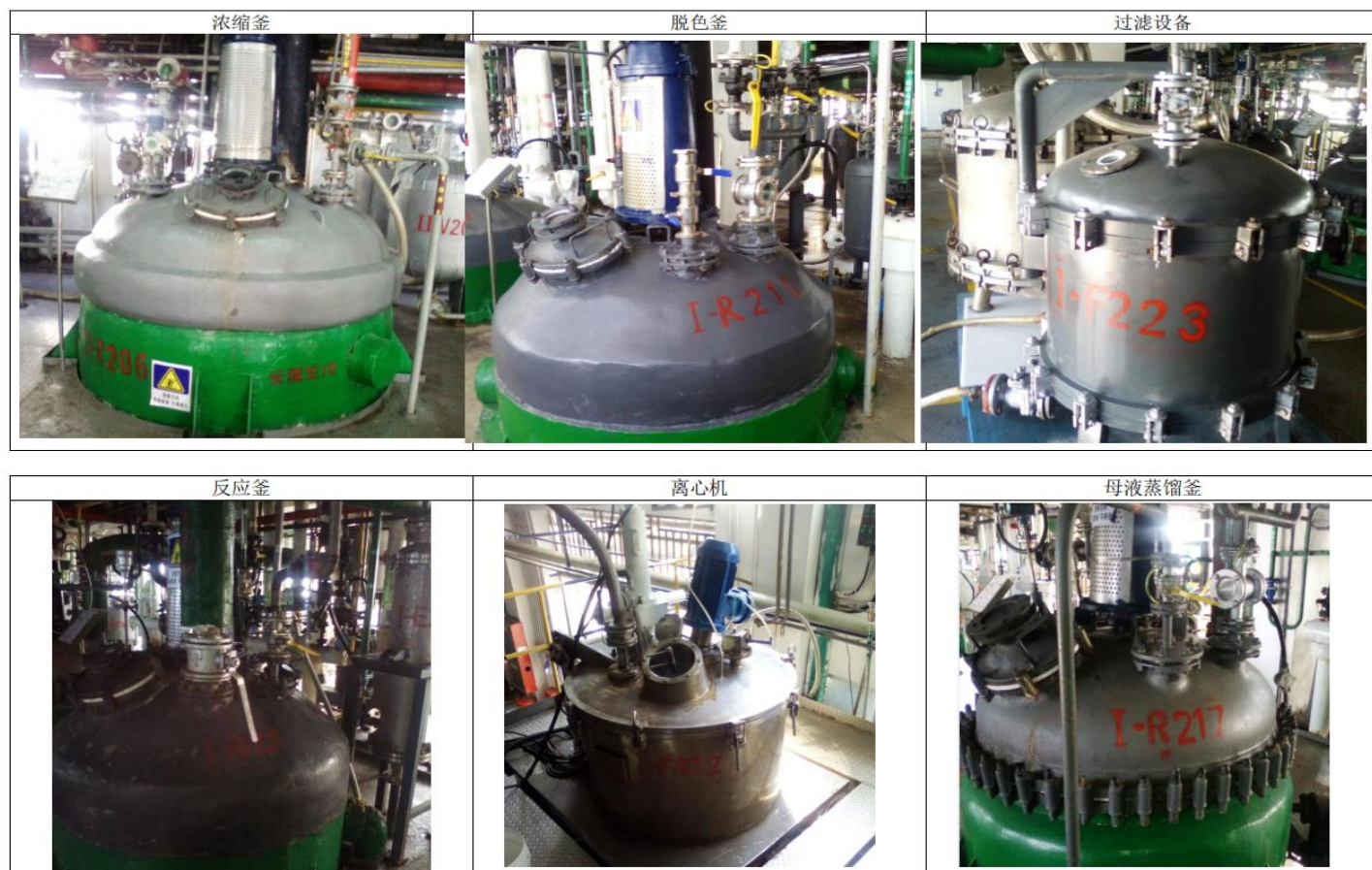
锂盐项目设备照片
