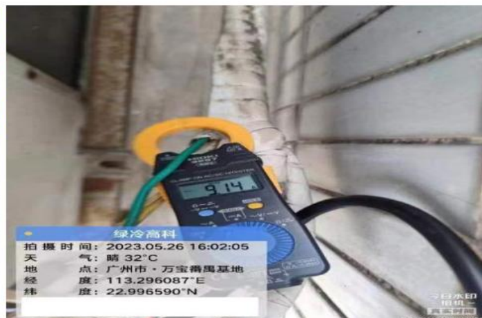
空调运行电流9.14安培
